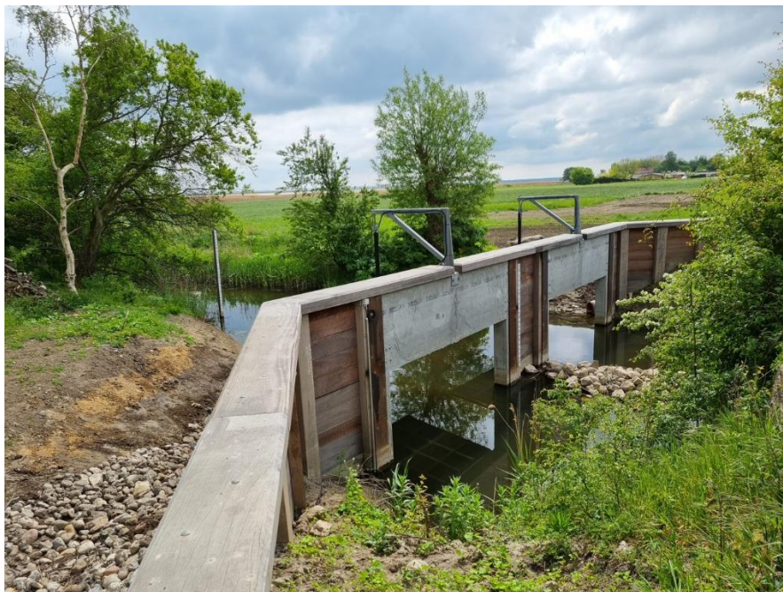
Figur 5.2 Højvandsport ved Skensved Å er klar til brug. Foto NIRAS, maj 2023
