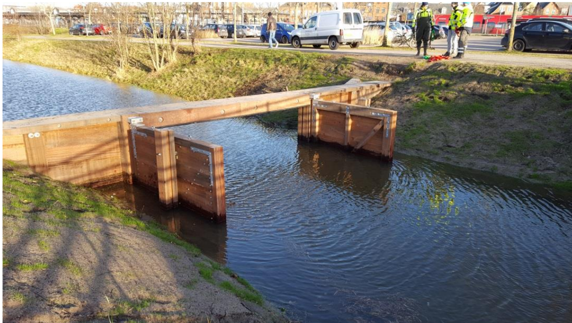
Figur 4.10 Eksempel på højvandslukke i hårdt træ med manuel betjening – Frederikssund.
